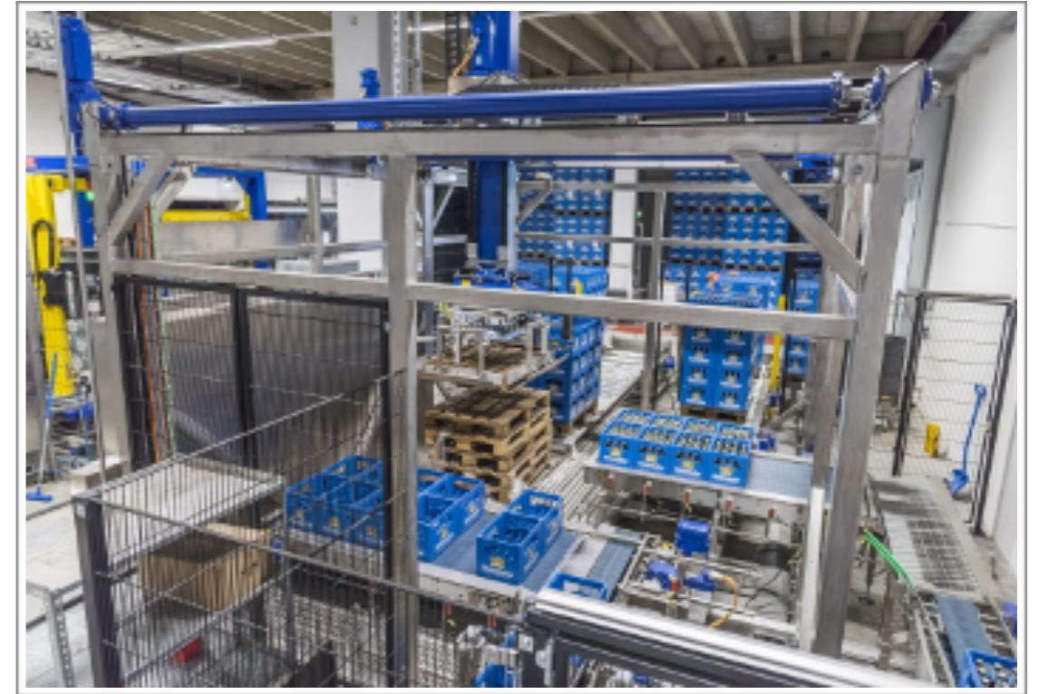
Die Umpackanlage erreicht eine Stundenleistung von 20.000 Flaschen beim 20er- und 22.000 Flaschen beim 24er-Karton. Beim 20er-auf-12er-Programm werden 10.000 Flaschen pro Stunde umgesetzt.
